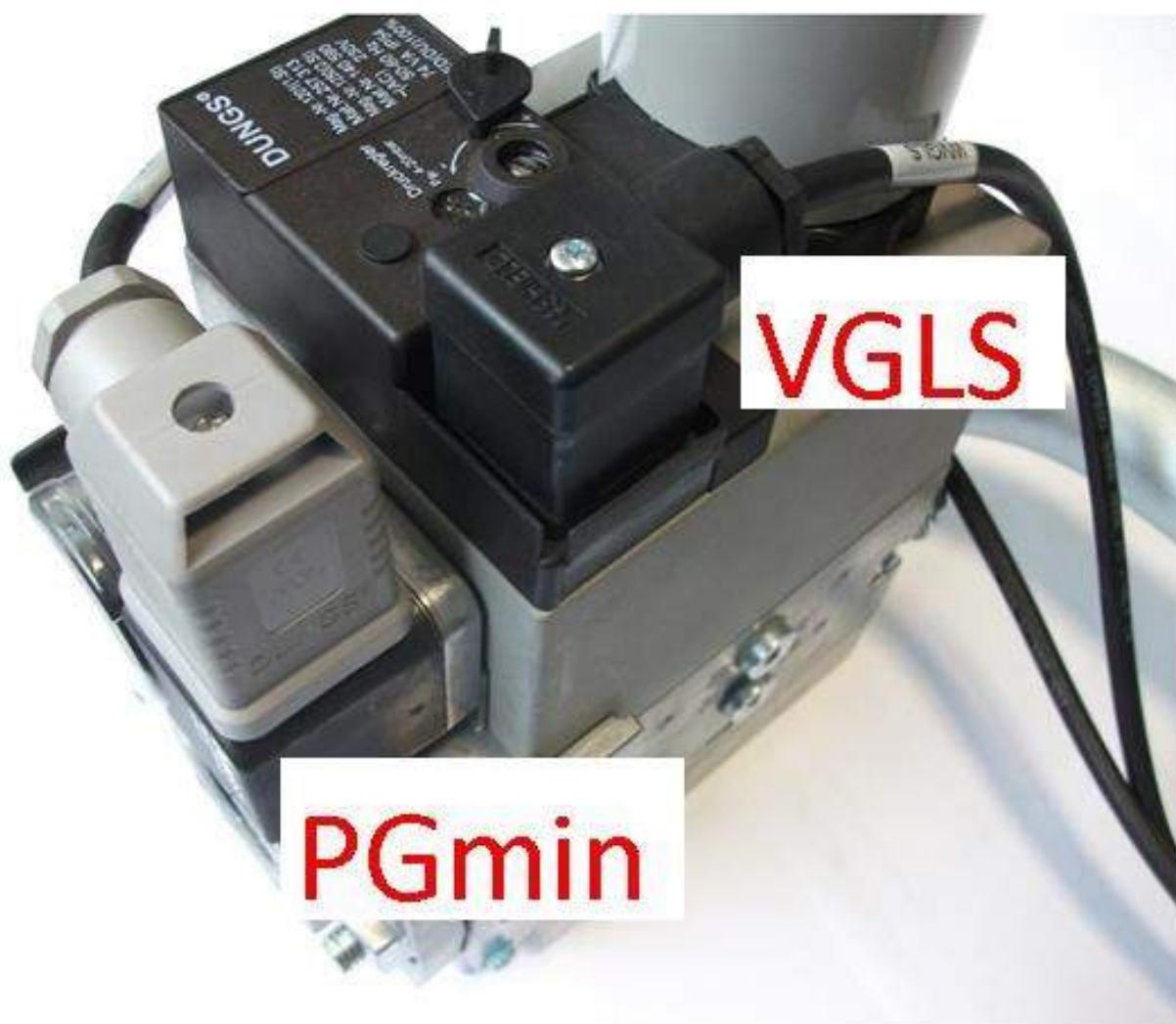
Fig. 2 Электрические соединения к газовой магистрали
