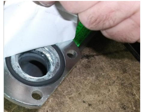
3) Снять заглушку из Труба ГАЗОВОЙ рампы и удостовериться, что прокладка фланца рампы установлена в правильном положении;
