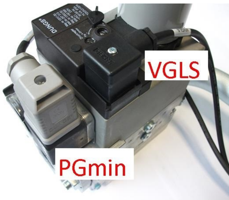
Fig. 7 Электрические соединения к газовой магистрали
